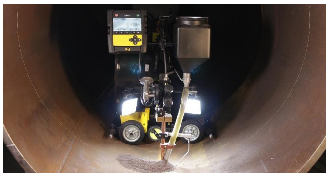
Versotrac com 3 rodas dentro de uma tubulação com KIT de lâmpadas LED.
